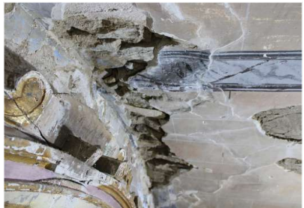
Detall de l'esquerda i pèrdua de suport | zona central de la volta 1 amb el parament de l'altar | Fotografia de Alba Morell
