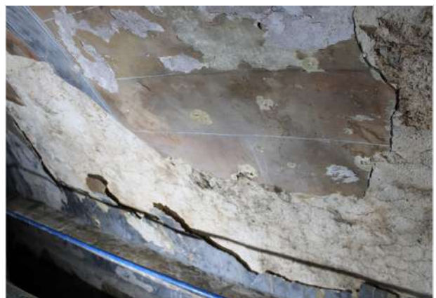
Detall de la gran separació del desplaçat de la capa de preparació | zona sud de la Volta 4 | Fotografia de Alba Morell
