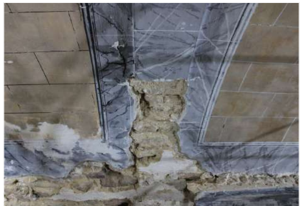
Pèrdua de suport d'arc faixó | zona sud entre la Volta 1 i 2 | Fotografia de Alba Morell
