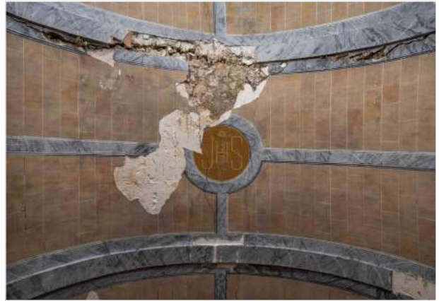
Esquerda i pèrdua de suport de l'arc faixó | zona central entre la Volta 2 i Volta 3 | Fotografia de CRBMC
