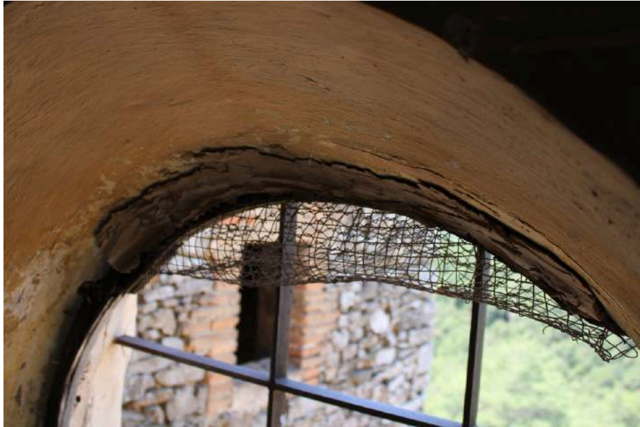
Reparació anterior de la finestra amb ciment ràpid i reixa de fil-ferro| Part superior de la finestra òcul| Fotografia de Alba Morell
