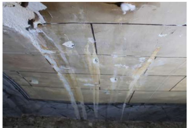
Detall d'escorrenties i pèrdua de policromia del S.XIX | zona nord de la Volta 1 | Fotografia de Alba Morell
