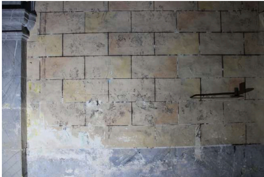
Mur de la capella dels Dolors on s'ha identificat verd maragda i groc de crom just sota el carreuat | Fotografia de Núria Jutglar
