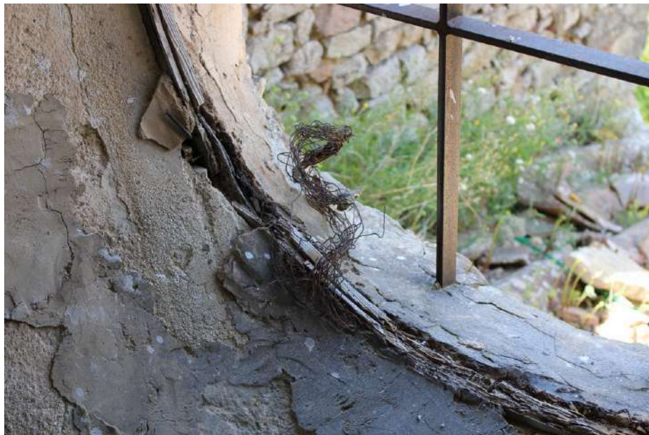
Detall de reparació anterior de ciment ràpid i fil-ferro| Part inferior de la finestra òcul| Fotografia de Alba Morell
