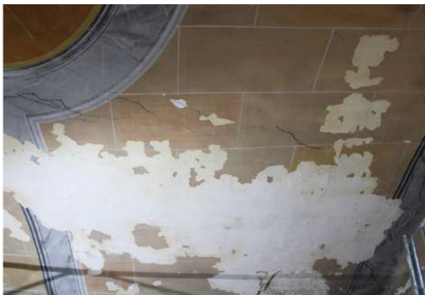
Pèrdua de capa pictòrica del S. XIX| zona nord- central de la Volta 3 | Fotografia de Alba Morell
