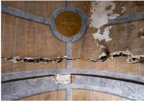
Esquerda i pèrdua de suport d'arc faixó | zona central entre la Volta 3 i Volta 4 | Fotografia de CRBMC
