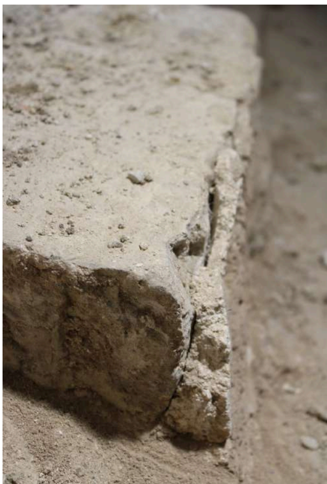
Detall de la separació del morter original amb el suport | absidiola nord | Fotografia de Alba Morell
