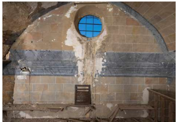
Escorrenties de la finestra absidial| zona paret de l'absis | Fotografia de CRBMC
