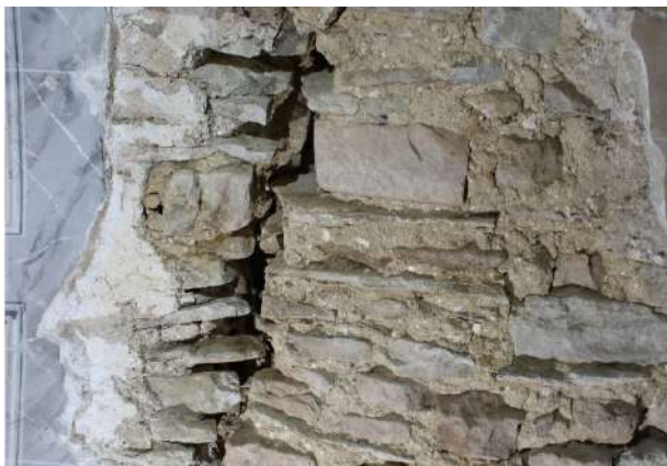
Detall d'esquerda i pèrdua de suport | zona central entre la Volta 2 i Volta 3 | Fotografia de Alba Morell
